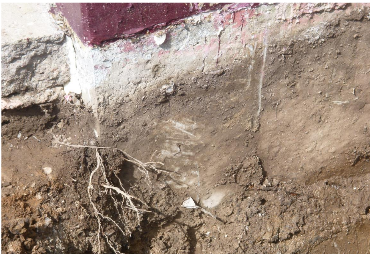
Фото Ф-5.32. Отсутствие вертикальной гидроизоляции на цокольных панелях
