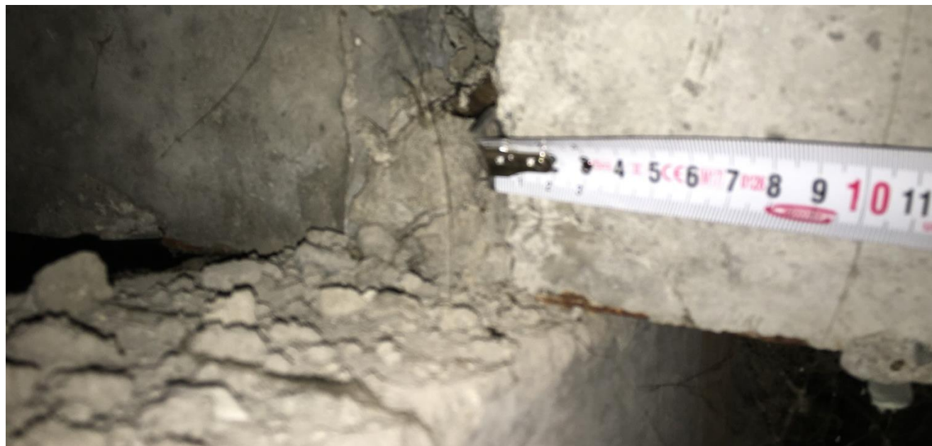
Фото Ф3.3.4. Недостаточность опирания плиты покрытия (30 мм).
