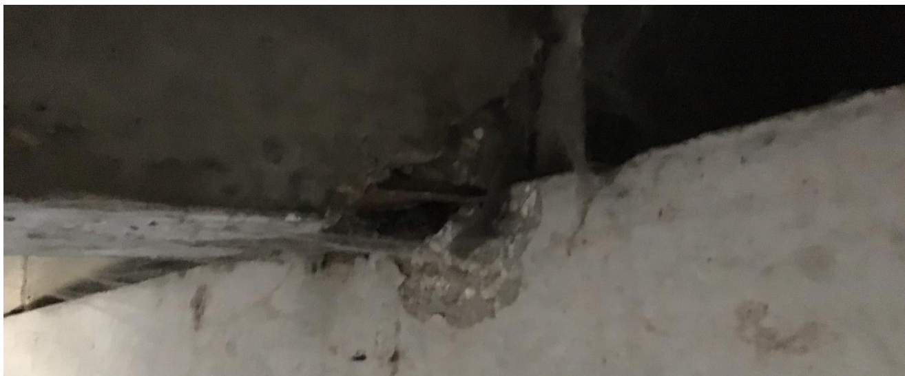
Фото Ф3.3.3. Сколы бетона, коррозия закладных деталей, отсутствие опирания.
