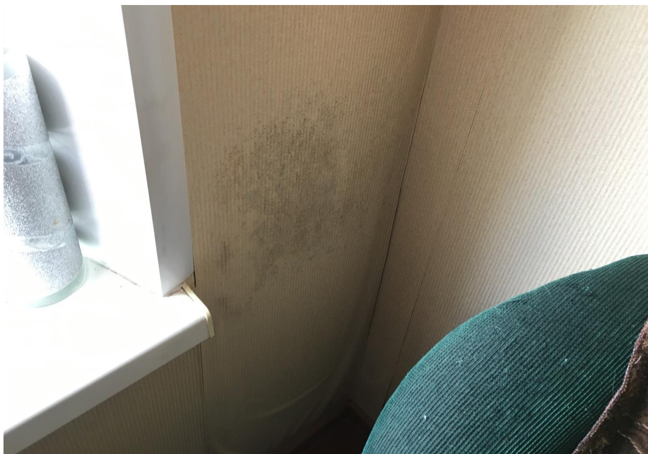
Фото Ф3.2.3.6. Квартира №69, этаж 9. Отклеивание обоев, плесень.
