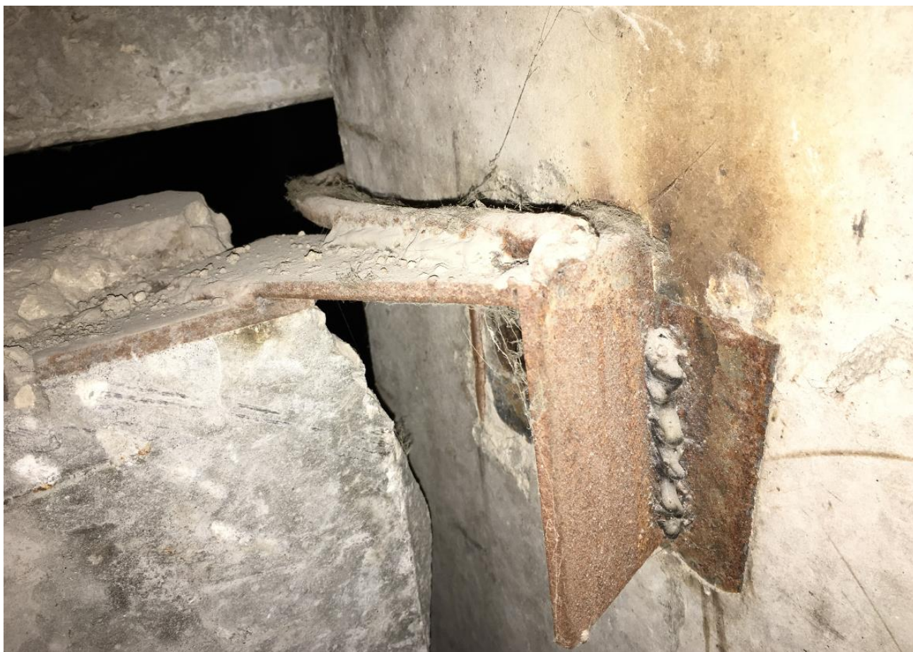
Фото Ф-5.12. Состояние узловых соединений в чердачном пространстве
