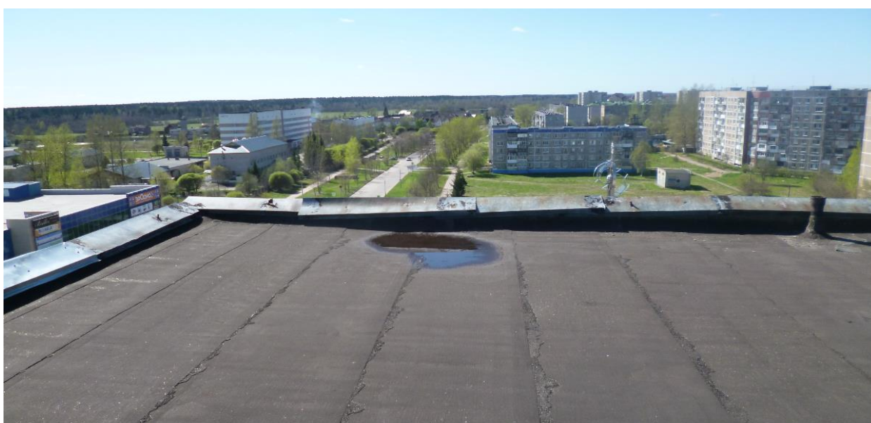
Фото Ф-3.5.1.3. Просадка кровли под обрушившейся плитой
