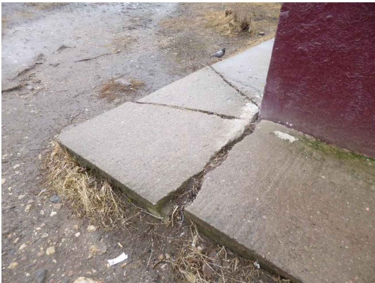
Фото Ф3.2.1.1. Трещины в теле отмостки.
