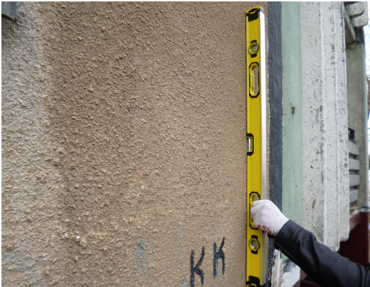
Фото Ф-5.5. Определение отклонения от вертикали наружных стен в уровне первого этажа
