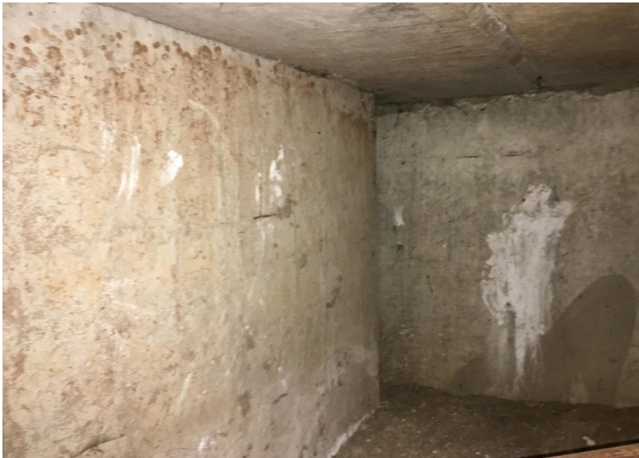
Фото Ф-5.25.Состояние сборных железобетонных конструкций в подвальном помещении
