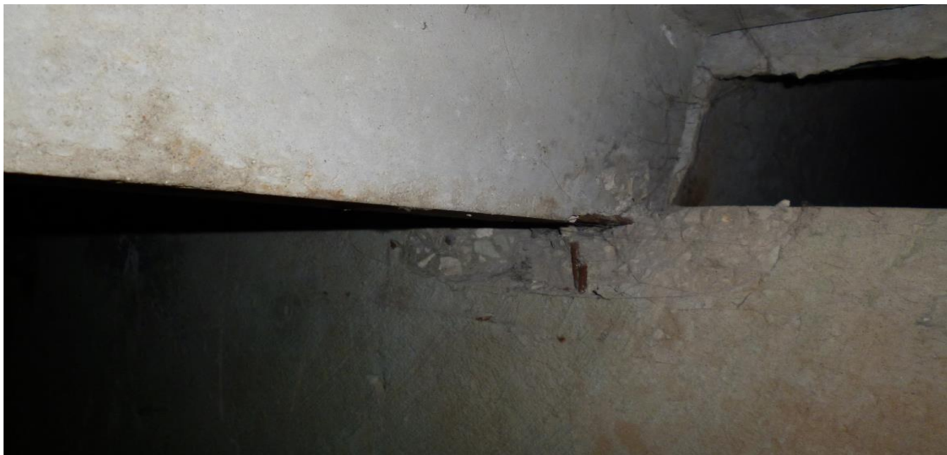
Фото Ф-3.5.4. Сколы бетона на опорных участках несущих стеновых панелей
