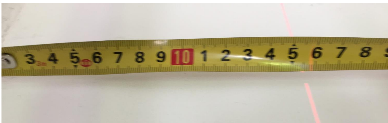
Фото Ф3.2.3.3. Квартира №11, 3 этаж. Отклонение наружной стеновой панели.
