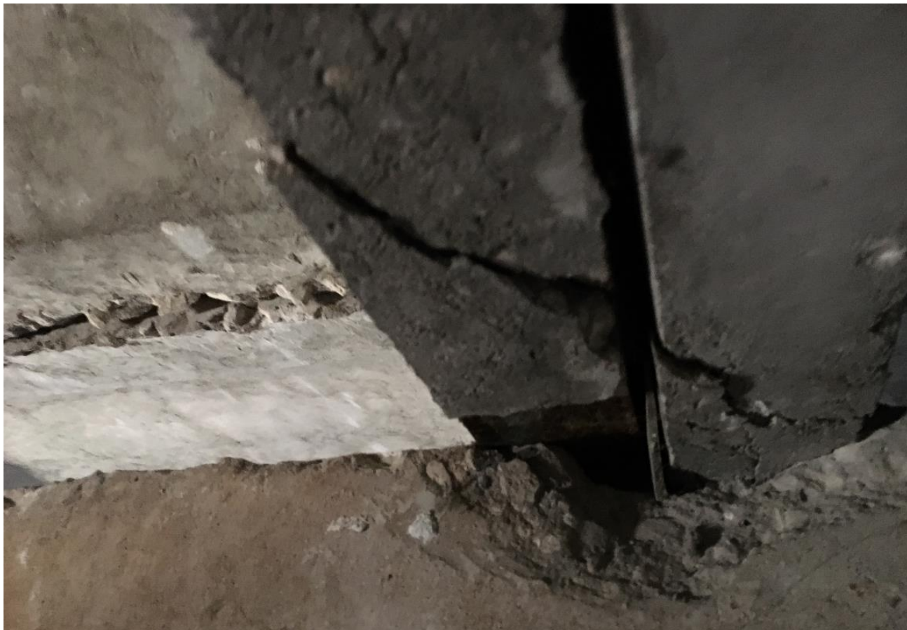
Фото Ф-5.13. Скалывание бетона в опорной зоне плиты покрытия (аварийное состояние)
