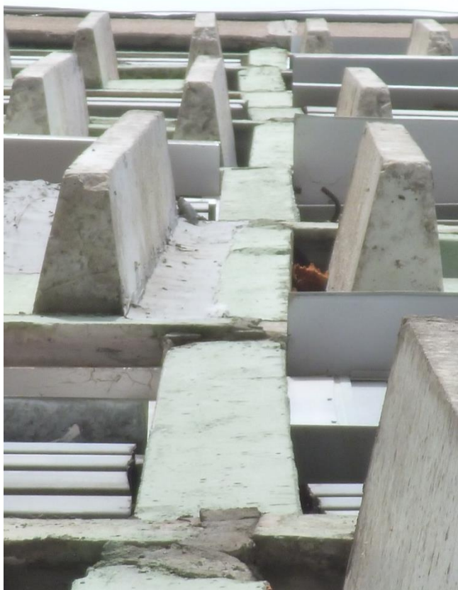
Фото Ф3.2.4.1 Отклонения плит лоджий.
