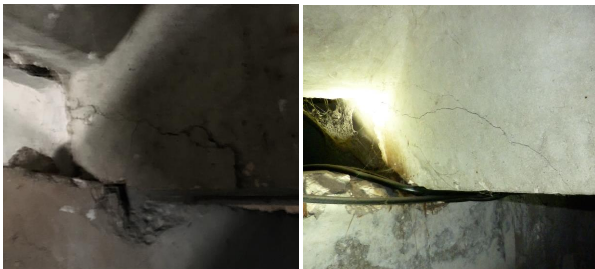
Фото Ф-3.5.5. Сколы бетона на опорных участках продольных ребер
