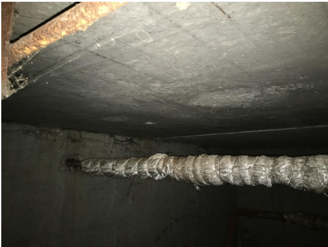
Фото Ф3.4.1. Состояние плит перекрытия в подвале.
