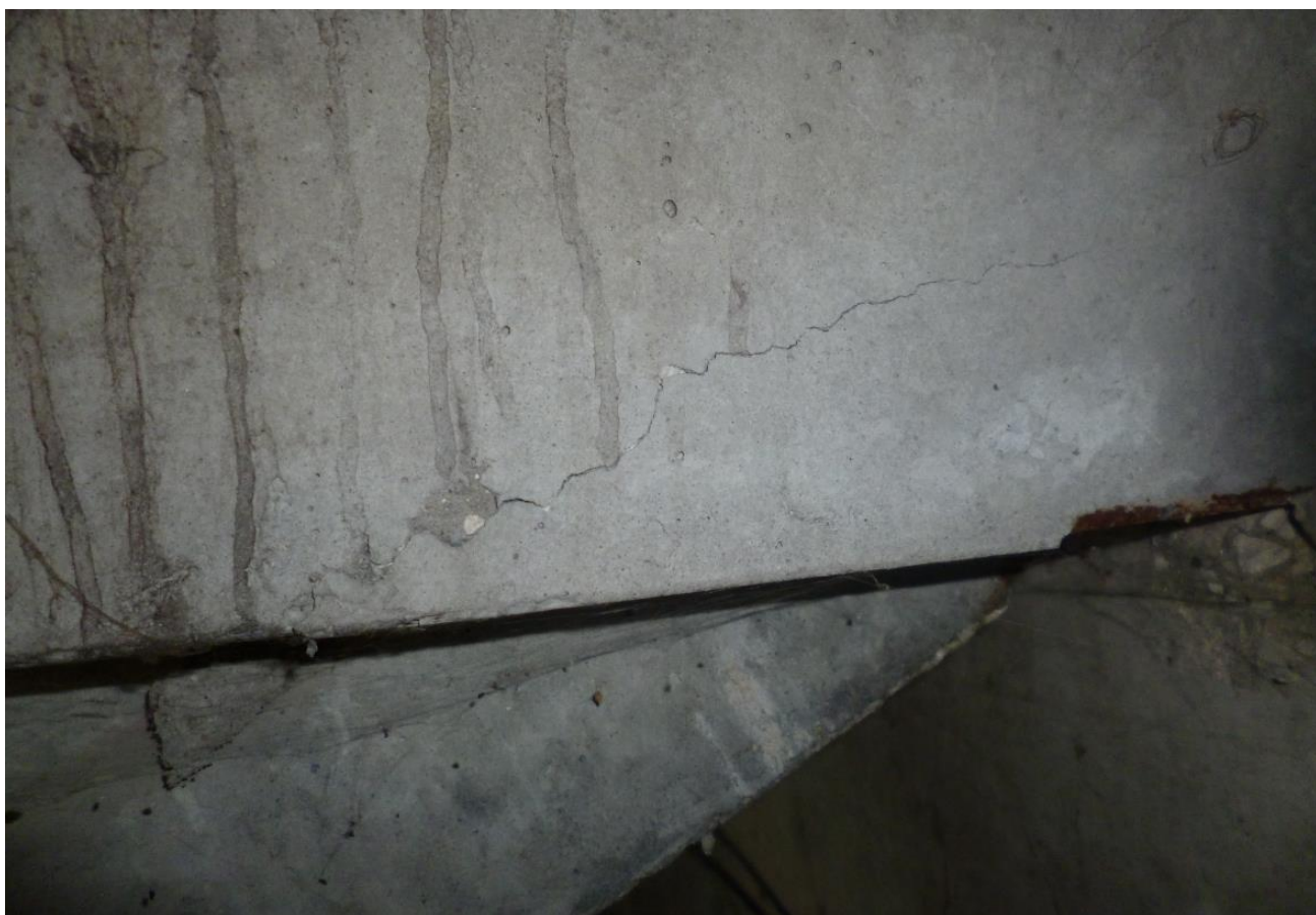
Фото Ф-5.18. Скалывание бетона в опорной зоне продольного ребра плиты покрытия
