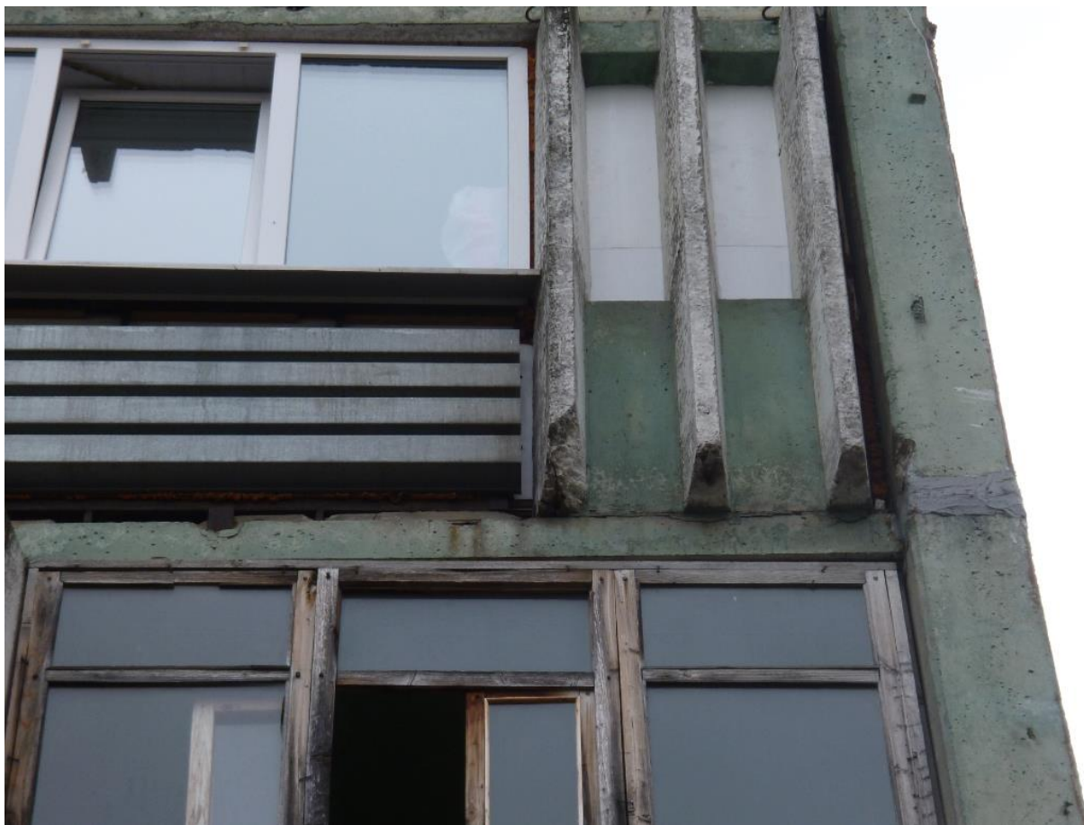
Фото Ф-5.1. Состояние отдельных элементов фасада
