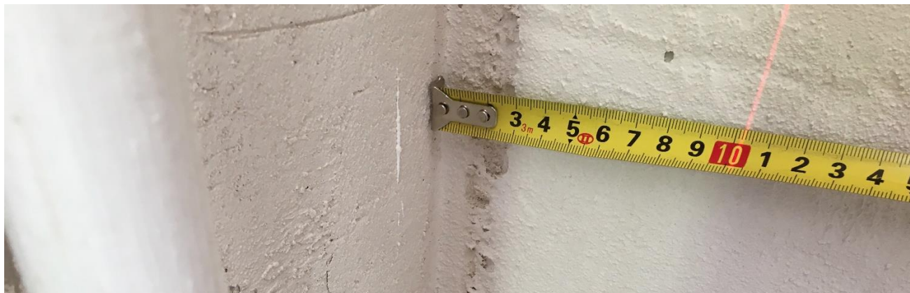
Фото Ф3.2.3.2. Квартира №11, 3 этаж. Отклонение наружной стеновой панели.
