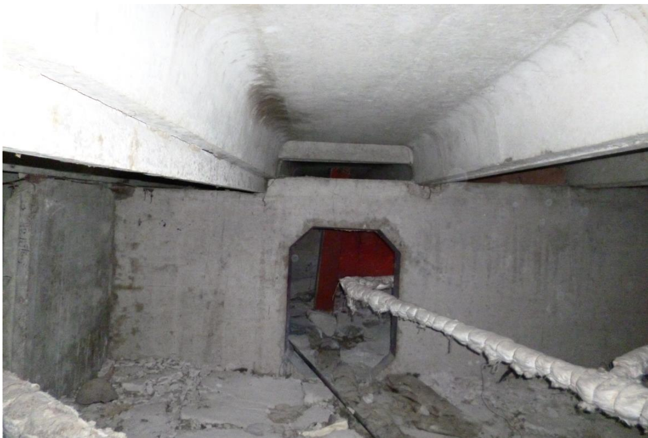
Фото Ф-5.11. Смещение плит покрытия относительно друг друга по вертикали
