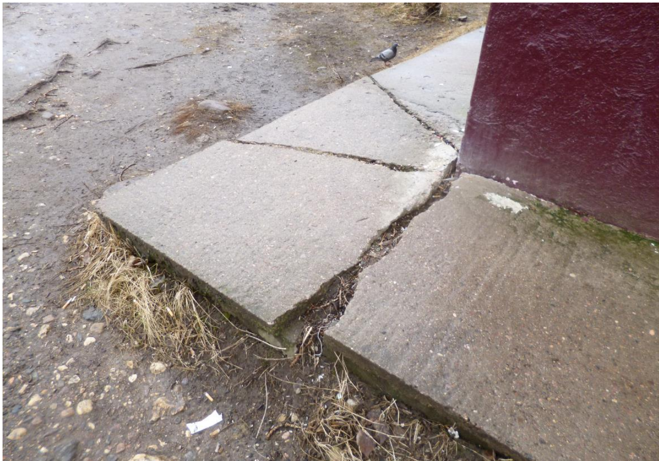
Фото Ф-5.3. Состояние отмотки у пересечения осей А'/26
