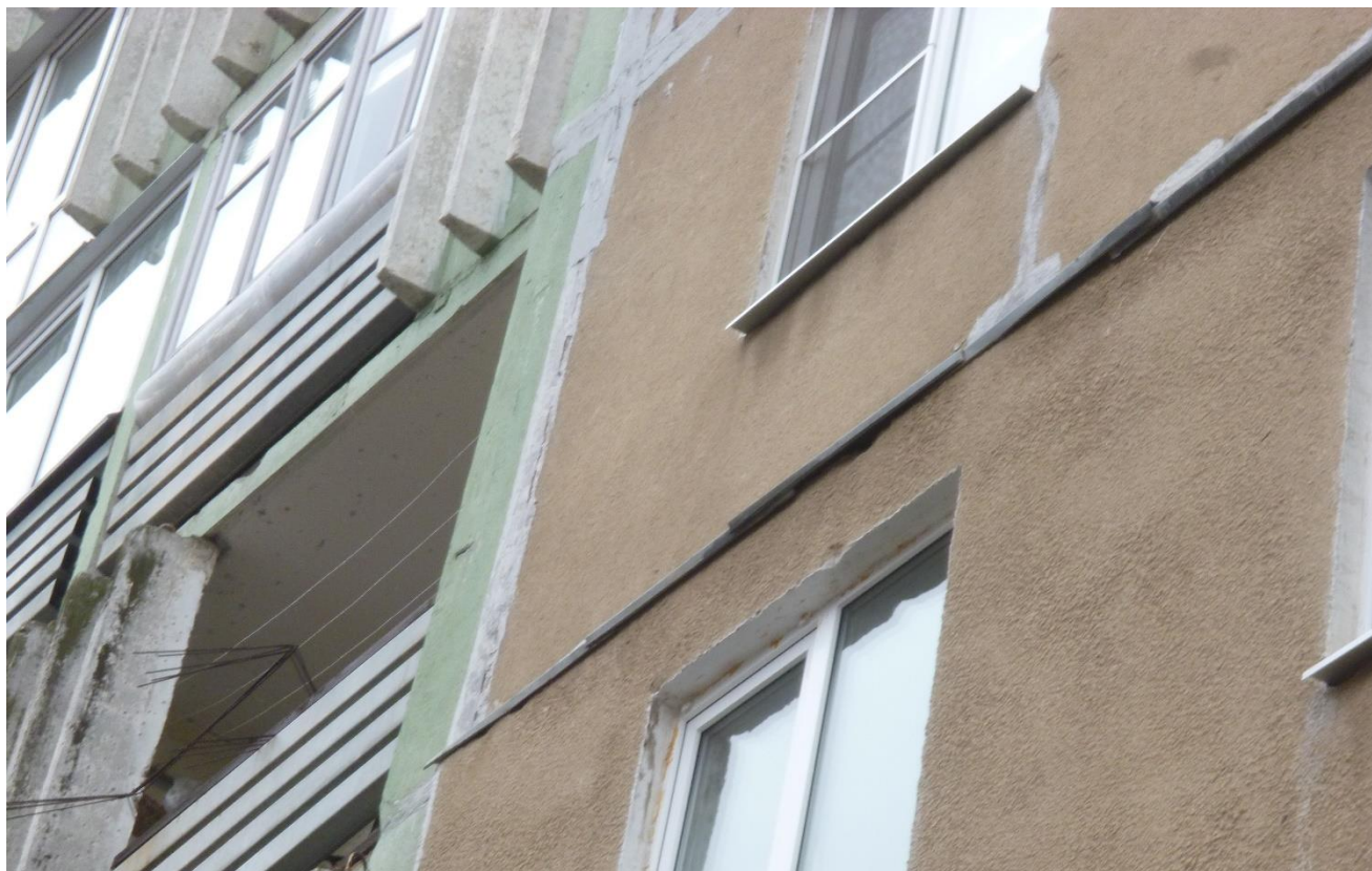
Фото Ф3.2.3.4. Квартира №11, 3 этаж. Отклонение наружной стеновой панели (снаружи).
