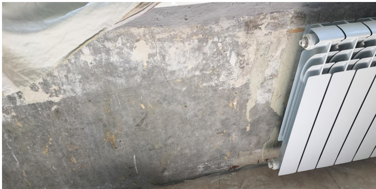
Фото Ф3.2.3.1. Квартира №11, 3 этаж. Волосяные трещины.
