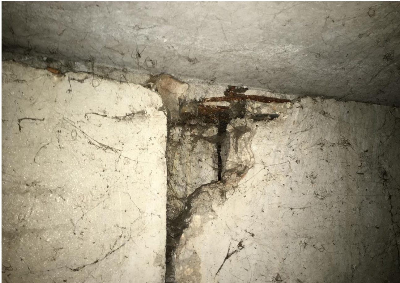
Фото Ф-5.27. Локальные разрушения подвальной стеновой панели в опорной зоне не эксплуатационного характера
