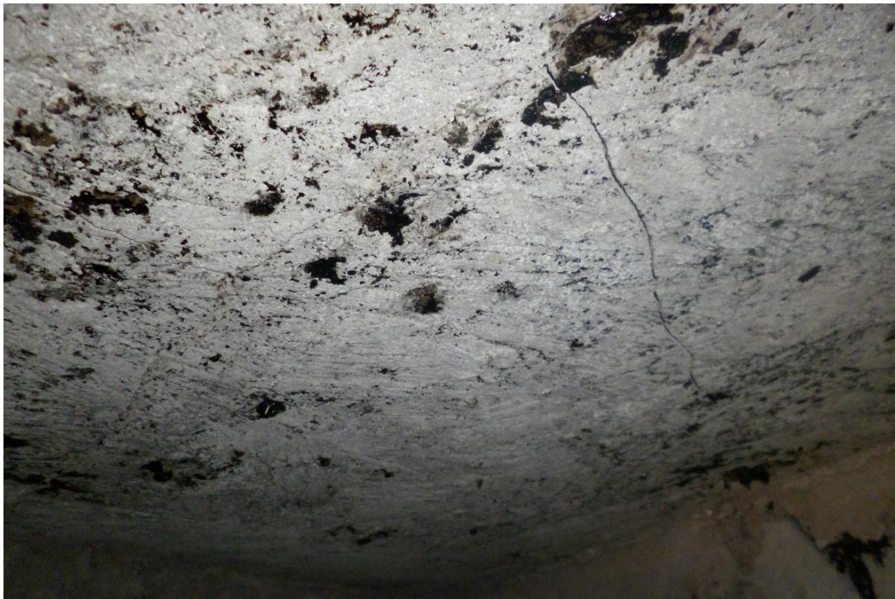
Фото Ф-5.17. Трещины в стяжке в месте обрушения плиты покрытия в осях 1-2/Б-В
