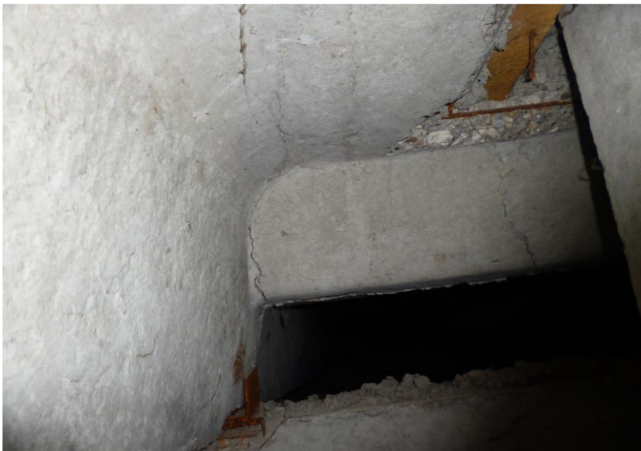
Фото Ф-5.24. Трещина в поперечном ребре плит покрытия
