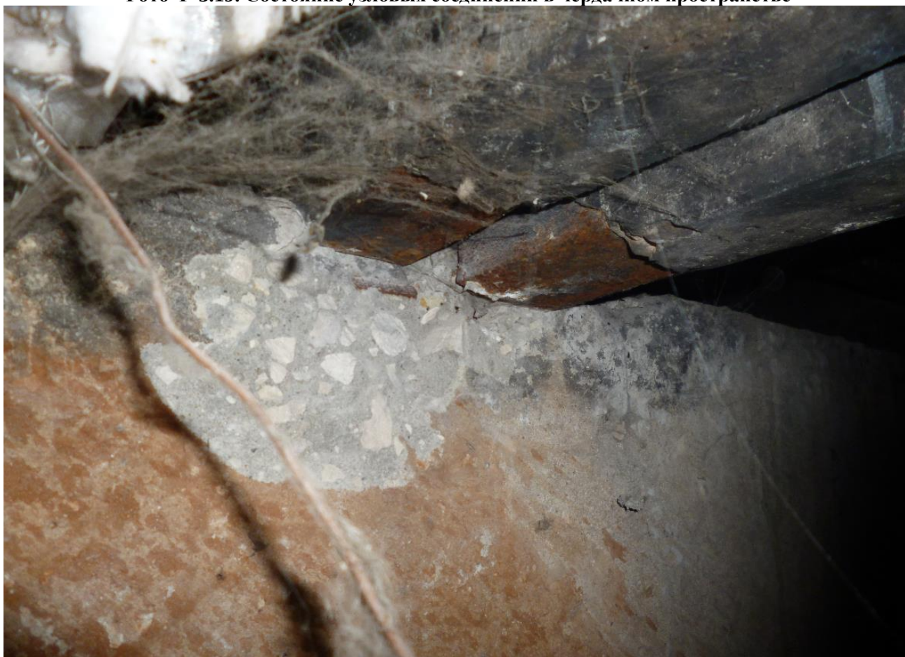
Фото Ф-5.20. Отсутствие закладных деталей в стеновой панели месте опирания плиты; скалывание бетона в месте опирания плит
