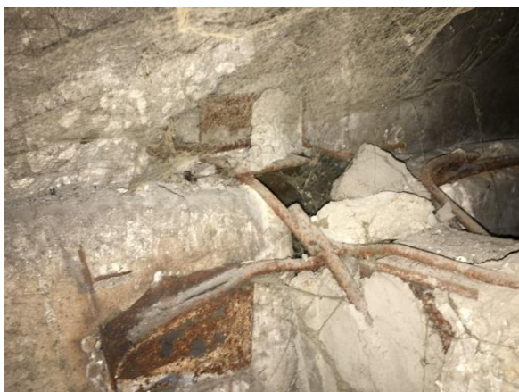
Фото Ф3.3.5 Коррозия закладных деталей.
