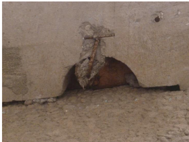
Фото Ф3.2.2.3. Коррозия закладных деталей.
