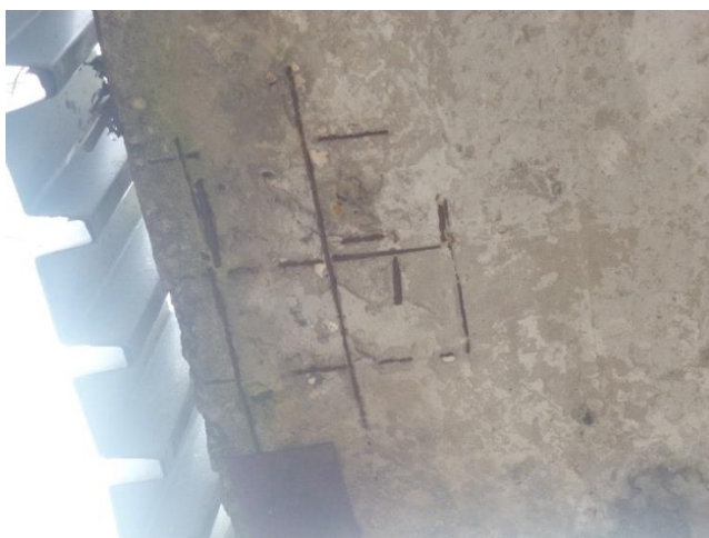
Фото Ф3.2.2.2. Оголение арматуры плиты козырька.
