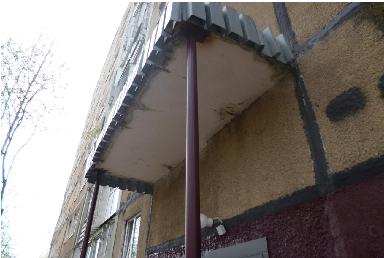
Фото Ф-5.28. Состояние козырьков входной группы
