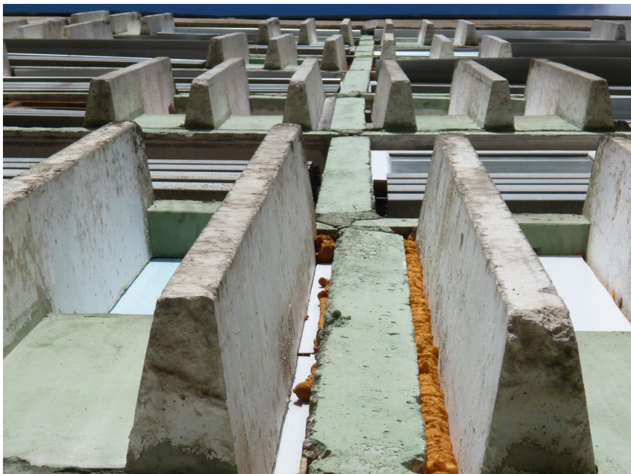
Фото Ф-5.10. Расположение несущих стеновых панелей со значительными эксцентриситетами
