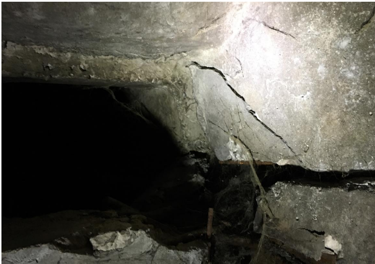
Фото Ф-5.16. Скалывание бетона в опорной зоне продольного ребра плиты покрытия (предположительно вследствие подвижки узловых соединений)
