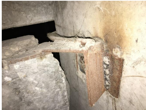
Фото Ф3.3.6. Коррозия закладных деталей.
