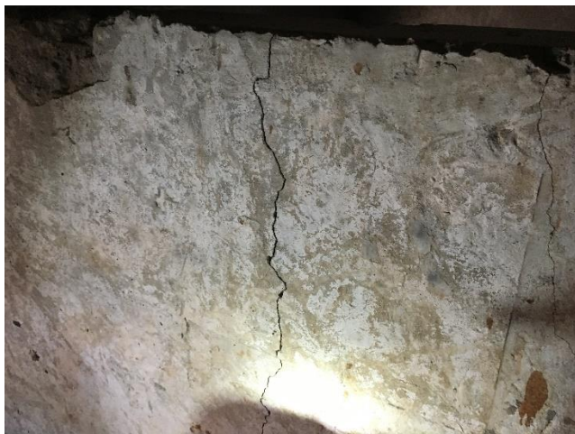
Фото Ф3.3.7 Трещины в стеновых панелях чердачного пространства.
