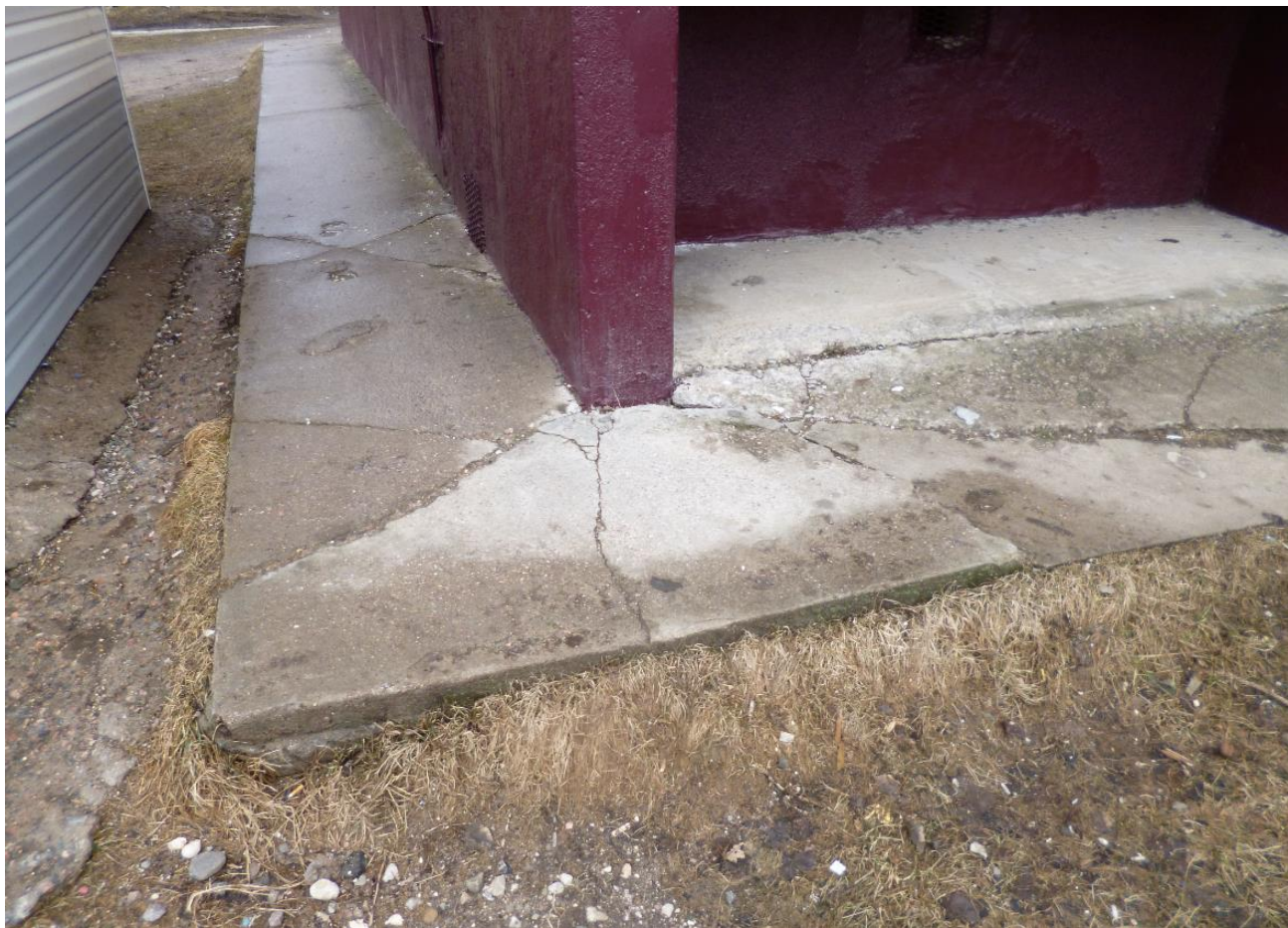
Фото Ф-5.4. Состояние отмотки у пересечения осей А/1
