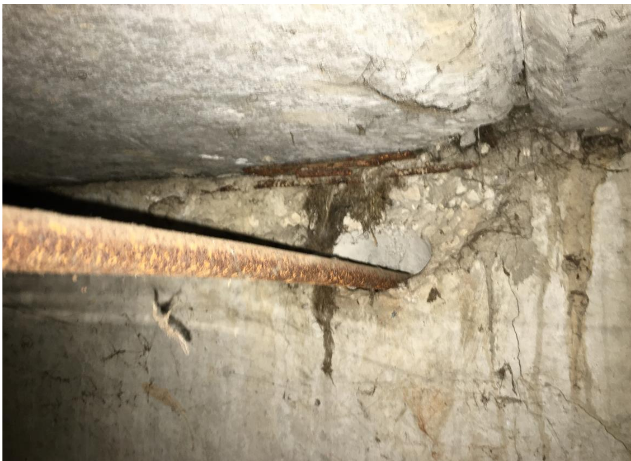
Фото Ф-5.26. Локальные разрушения подвальной стеновой панели в опорной зоне
