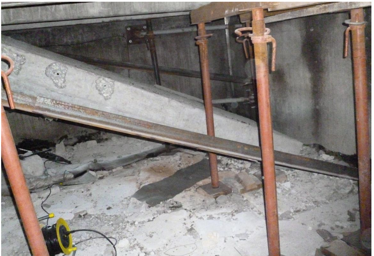
Фото Ф-5.22. Обрушение плиты в осях 1-2/Б-В; следы испытаний на вырыв со скалыванием у обрушенной плиты; затяжка углового профиля парапетной панели по оси 1
