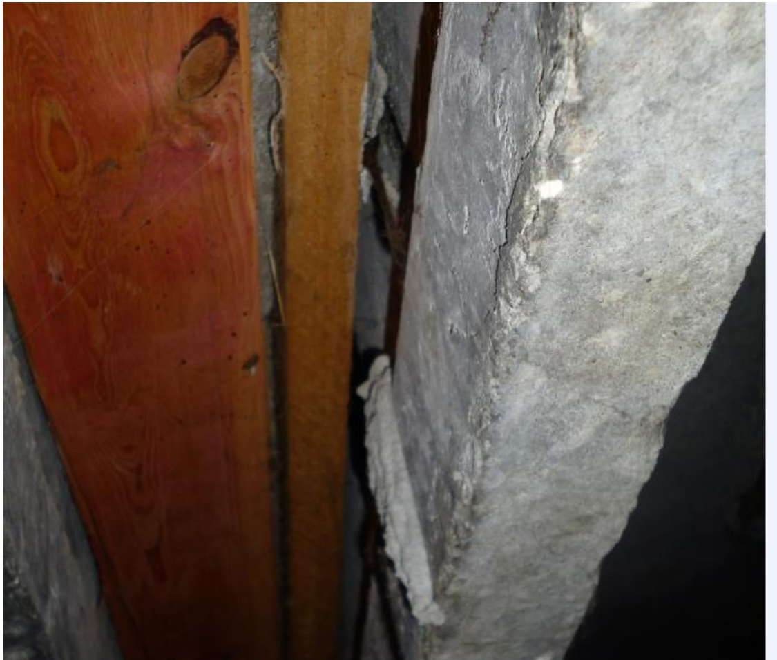
Фото Ф-5.21. Зазор между плитами покрытия в осях 1-2/Г-Д
