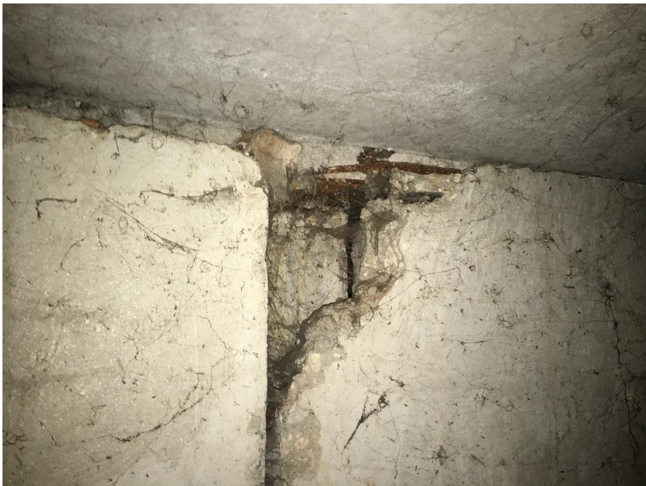
Фото Ф3.4.2. Коррозия закладных деталей плит перекрытия в подвале.
