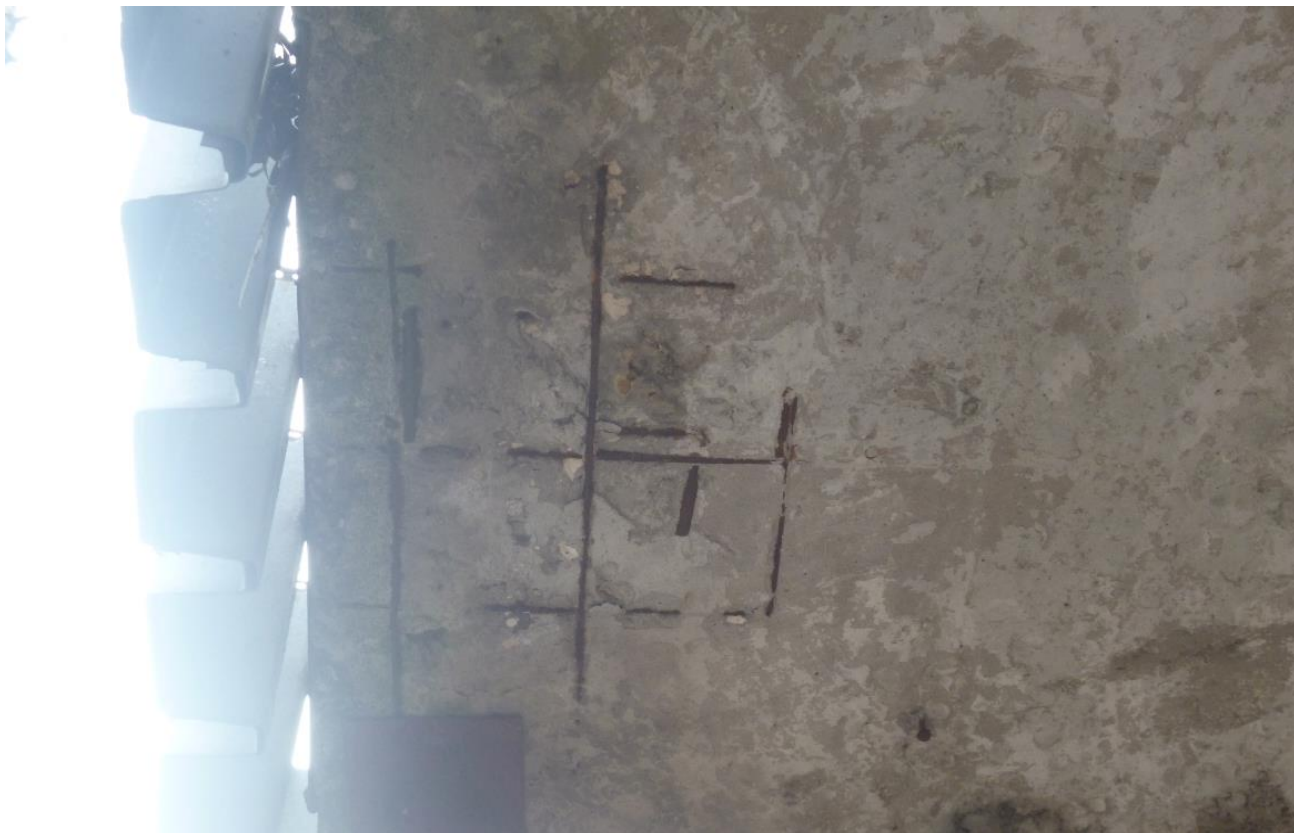
Фото Ф-5.30. Оголение арматурных сеток козырька входной группы
