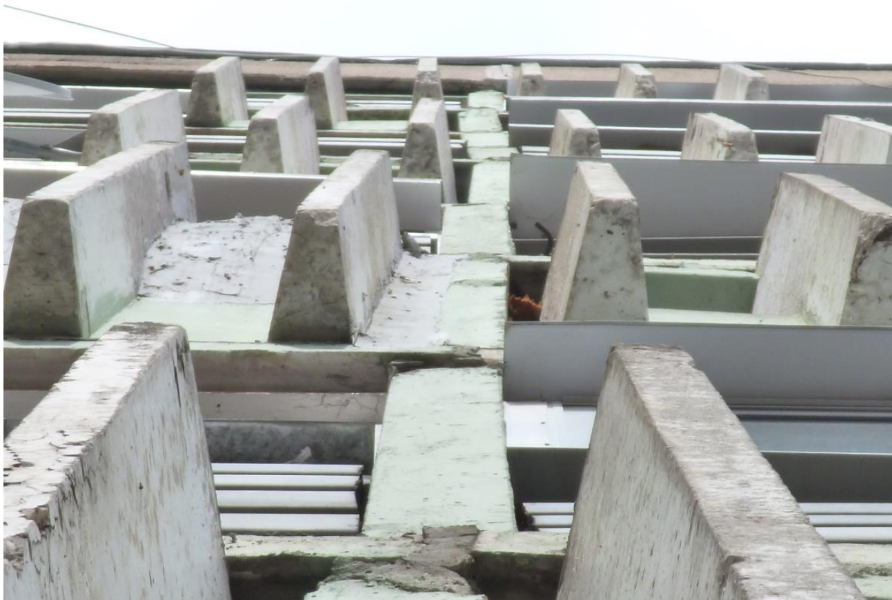
Фото Ф-5.9. Расположение несущих стеновых панелей со значительными эксцентриситетами
