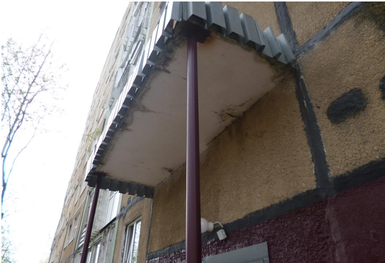
Фото Ф-5.29. Локальные разрушения подвальной стеновой панели в опорной зоне не эксплуатационного характера
