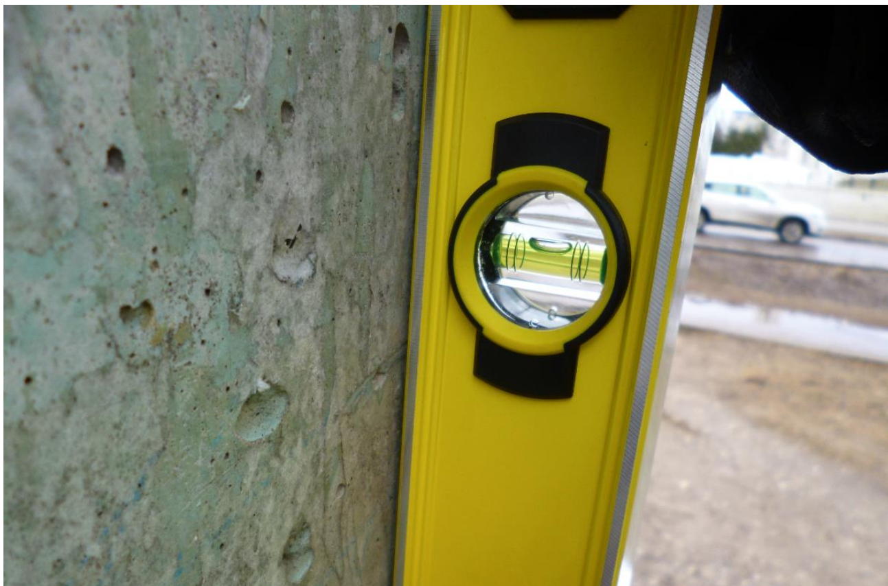
Фото Ф-5.6. Определение отклонения от вертикали наружных стен в уровне первого этажа
