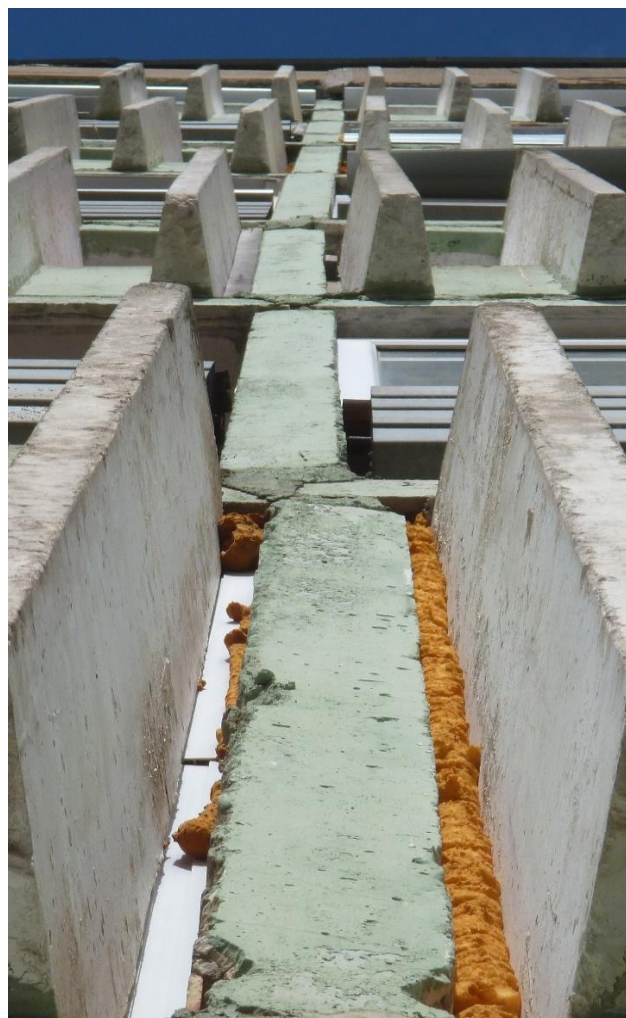
Фото Ф3.2.4.2 Отклонения плит лоджий.
