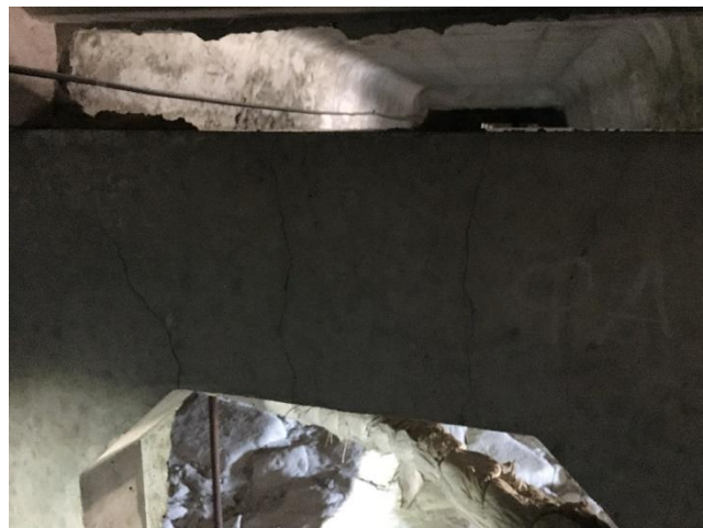
Фото Ф3.3.8. Трещины в стеновых панелях чердачного пространства.
