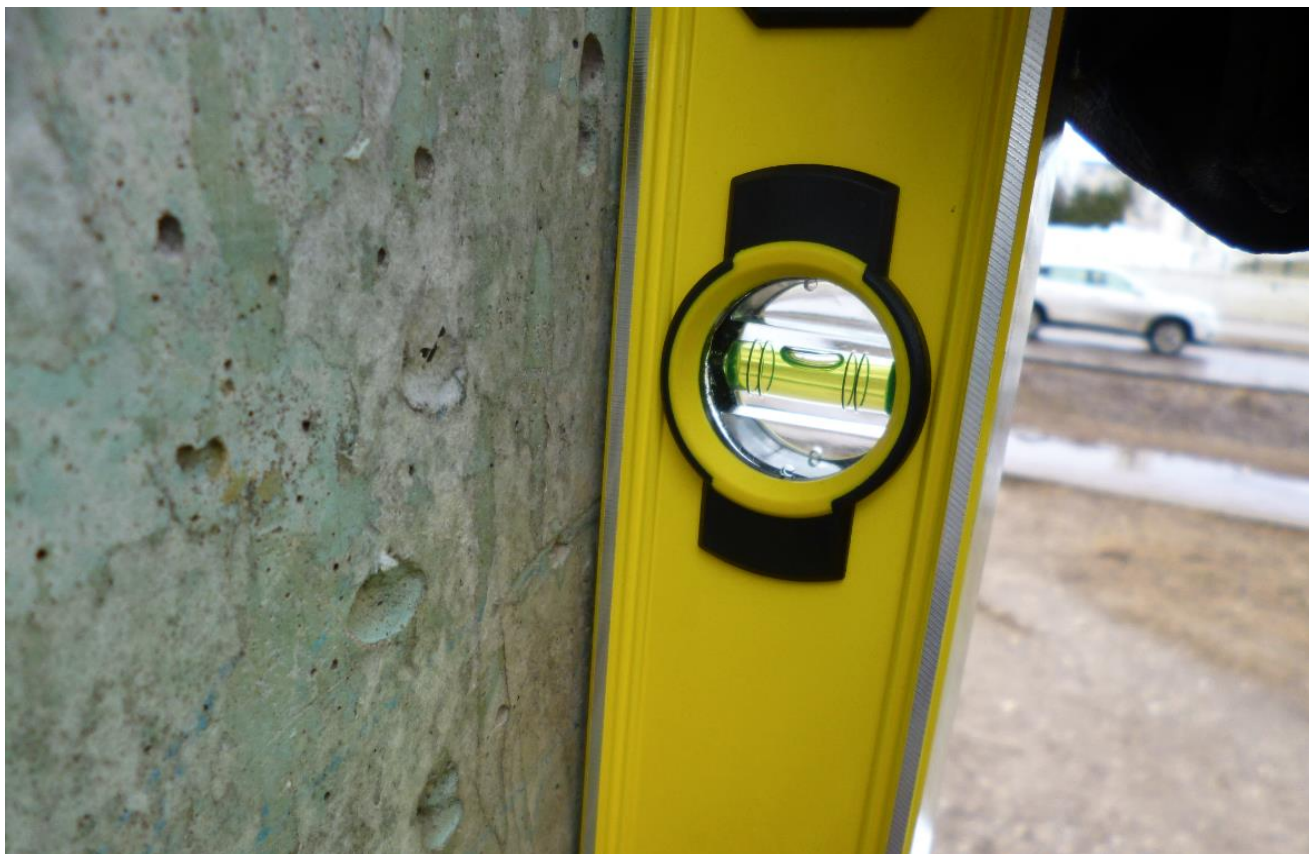
Фото Ф-5.7. Определение отклонения от вертикали наружных стен в уровне первого этажа
