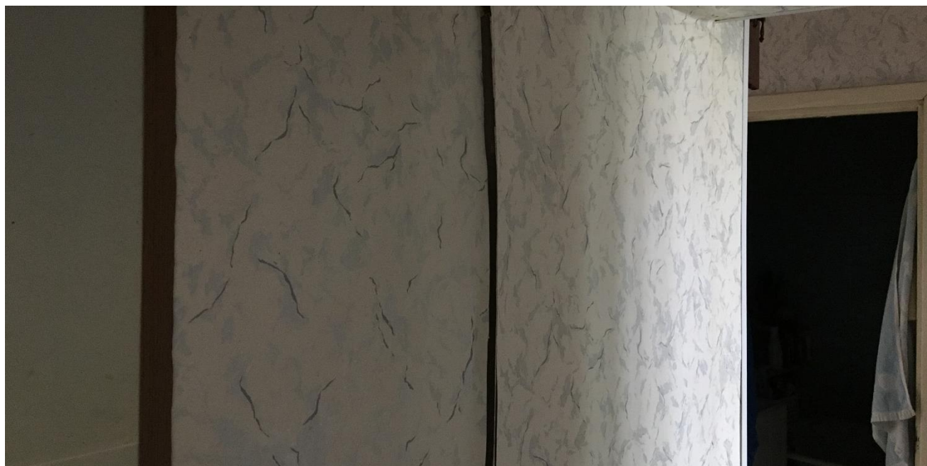
Фото Ф3.3.2. Отклеивание обоев в стыке внутренних стеновых панелей в квартире №100, 7 этаж.
