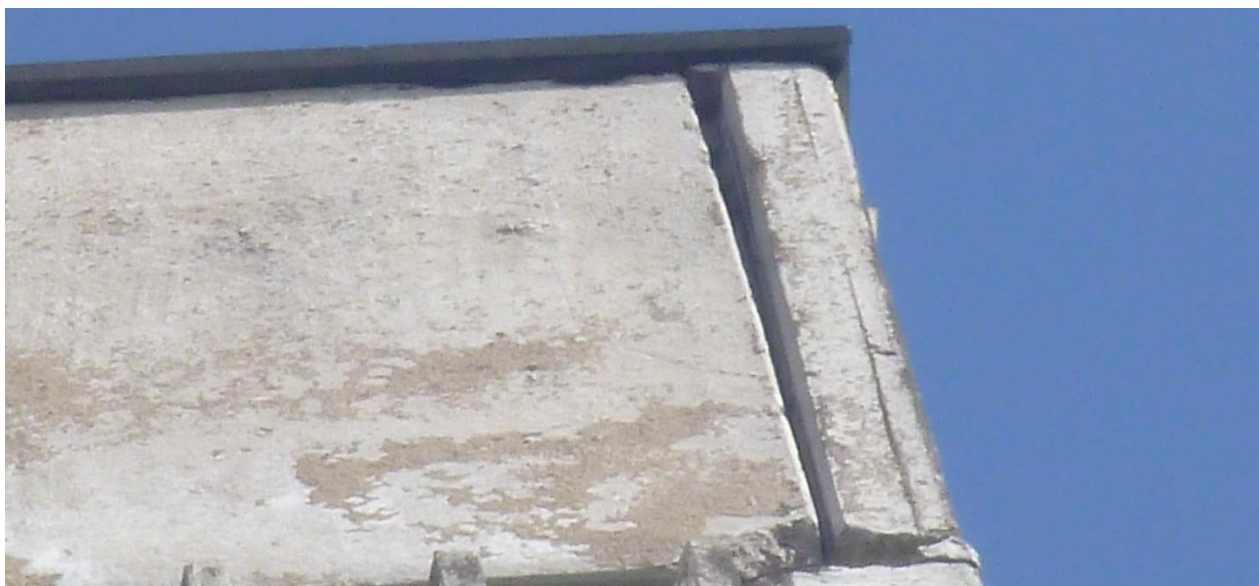
Фото Ф3.2.3.8. Смещение торцевой панели от оси 4.
