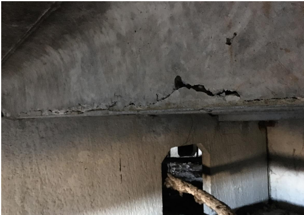
Фото Ф-5.15. Заводские дефекты в продольном ребре плиты покрытия
