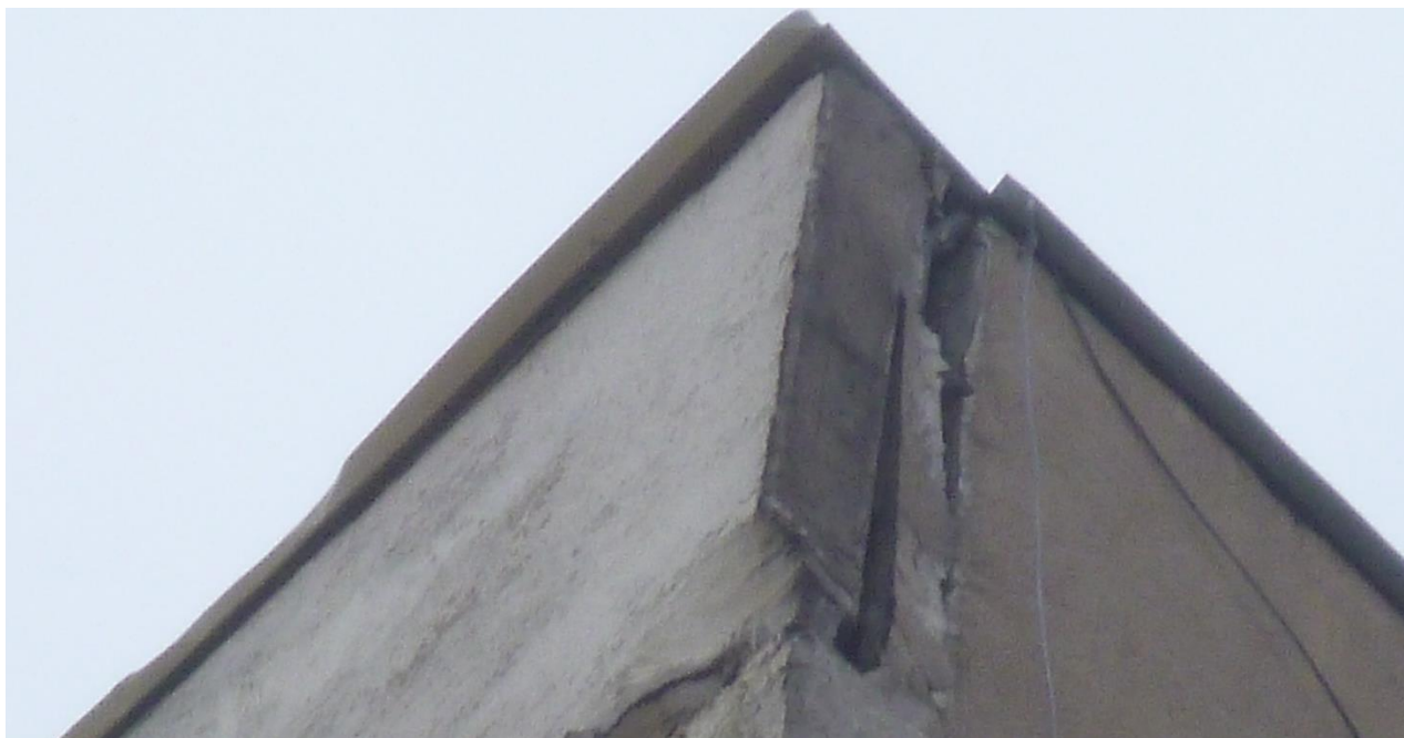
Фото Ф3.2.3.7. Смещение торцевой панели от оси 1.
