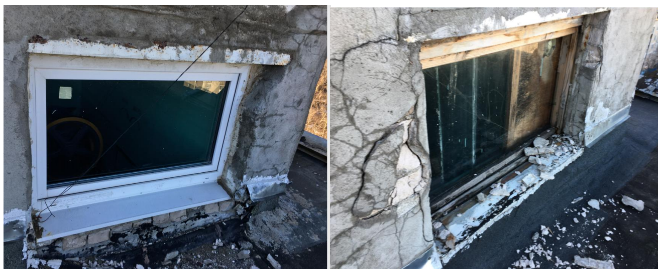
Фото Ф-3.5.1.4.Состояние штукатурного слоя, оконных блоков выходов на кровлю, примыкания кровельного «ковра» к выходам.
