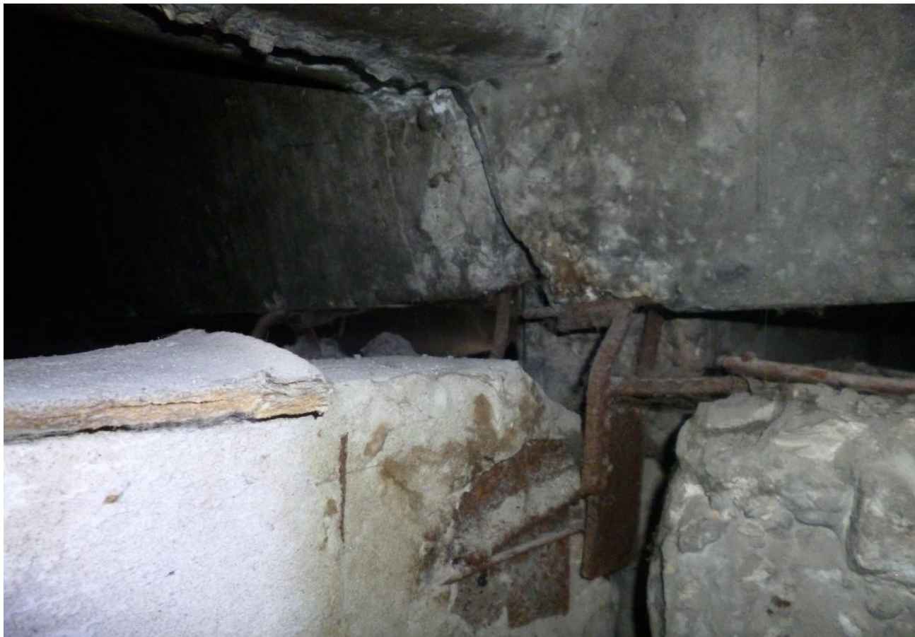
Фото Ф-5.19. Состояние узловых соединений в чердачном пространстве
