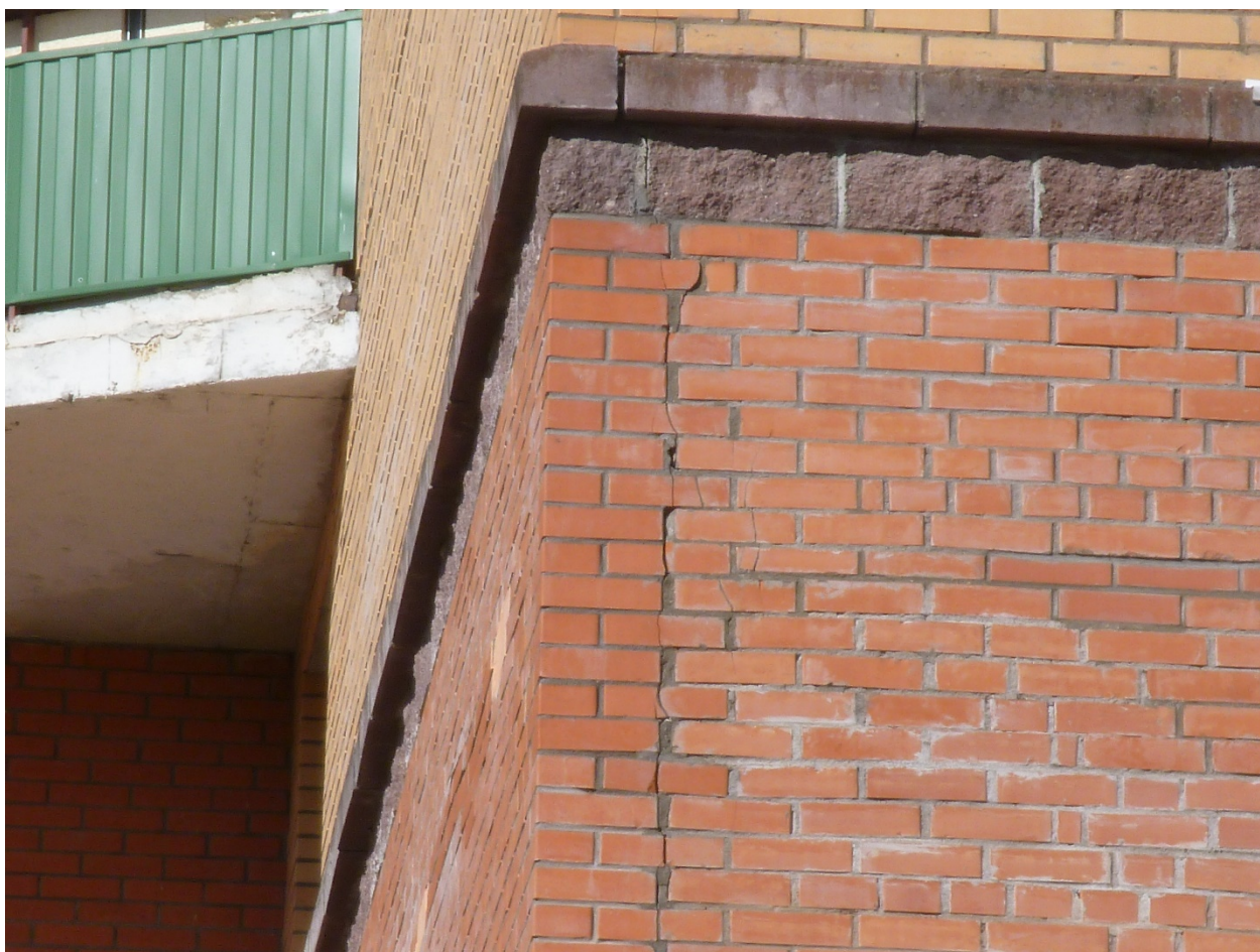
Фотофрагмент № 18 «Трещины в теле кирпичной кладки на углу здания, высолы»
