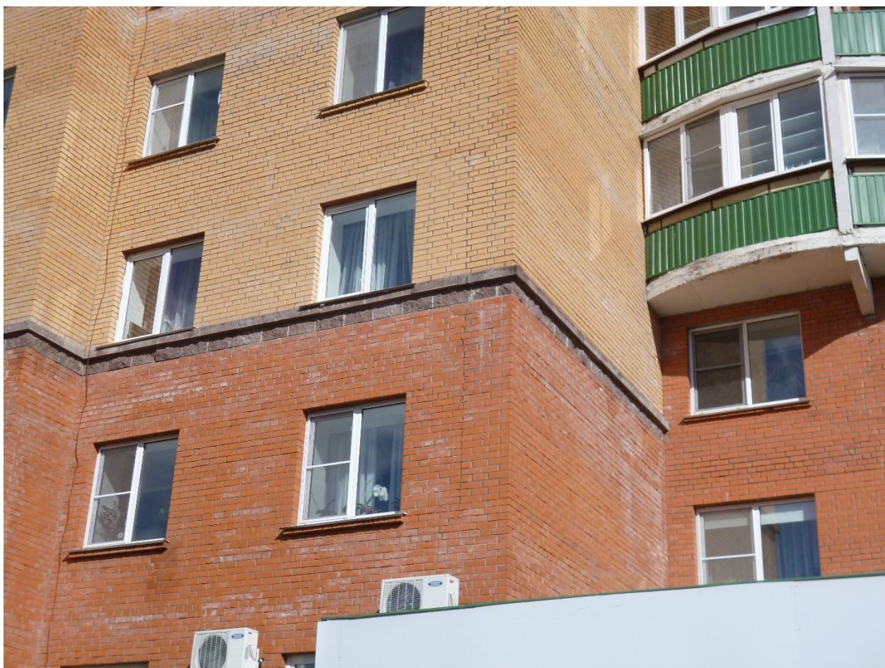
Фотофрагмент № 16 «Высолы, трещины в теле кирпичной кладки»
