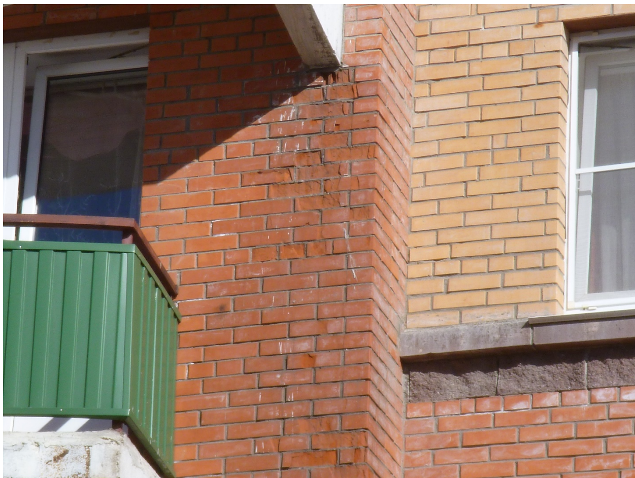
Фотофрагмент № 15 «Разрушения кирпича»
