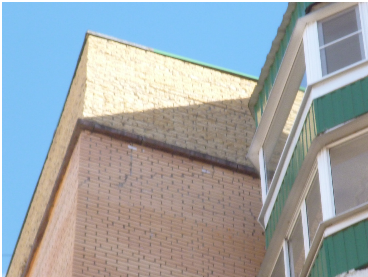
Фотофрагмент № 13 «Трещины в теле кладки, низкое качество кладки»
