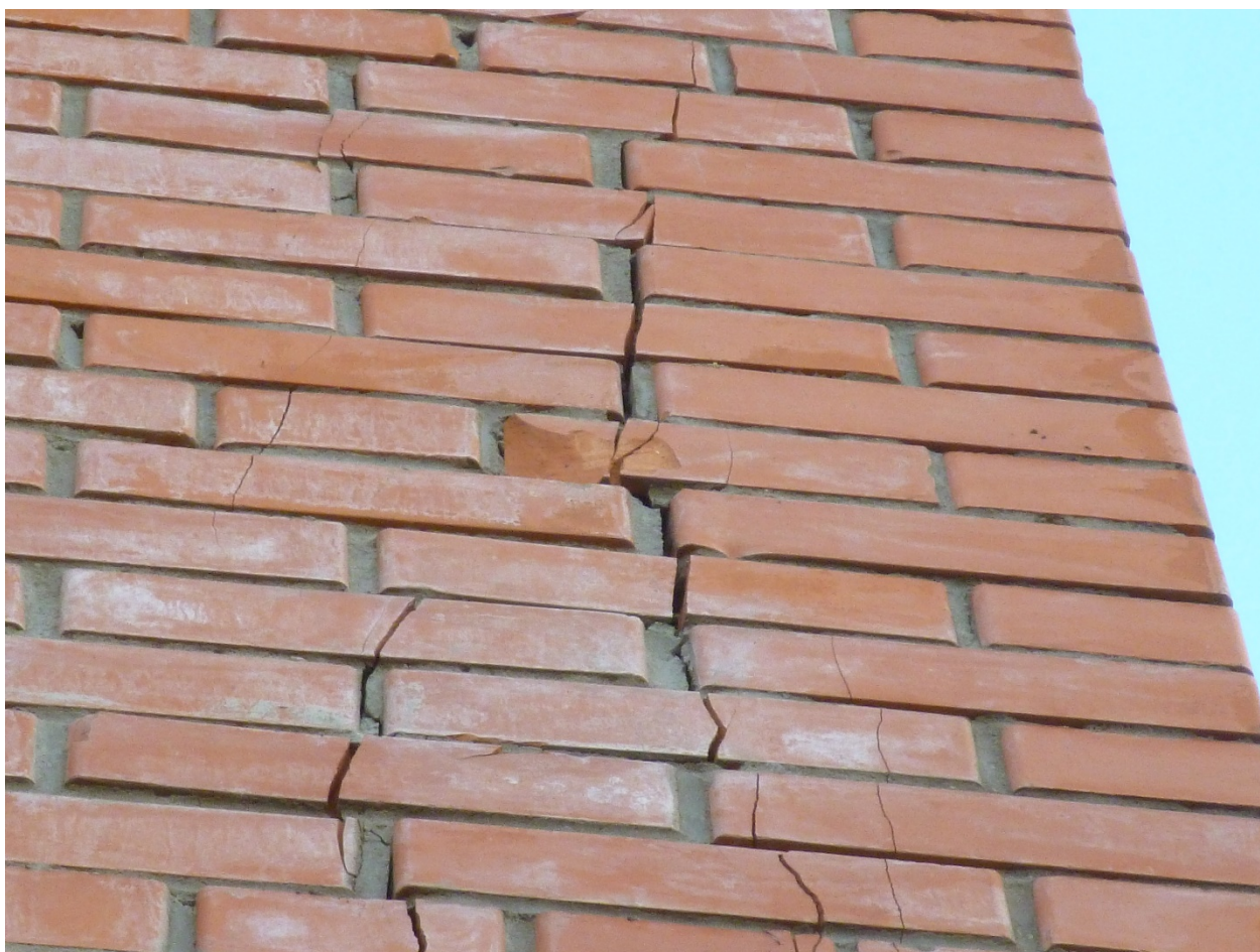
Фотофрагмент № 10 «Трещины в теле кладки на углу здания»
