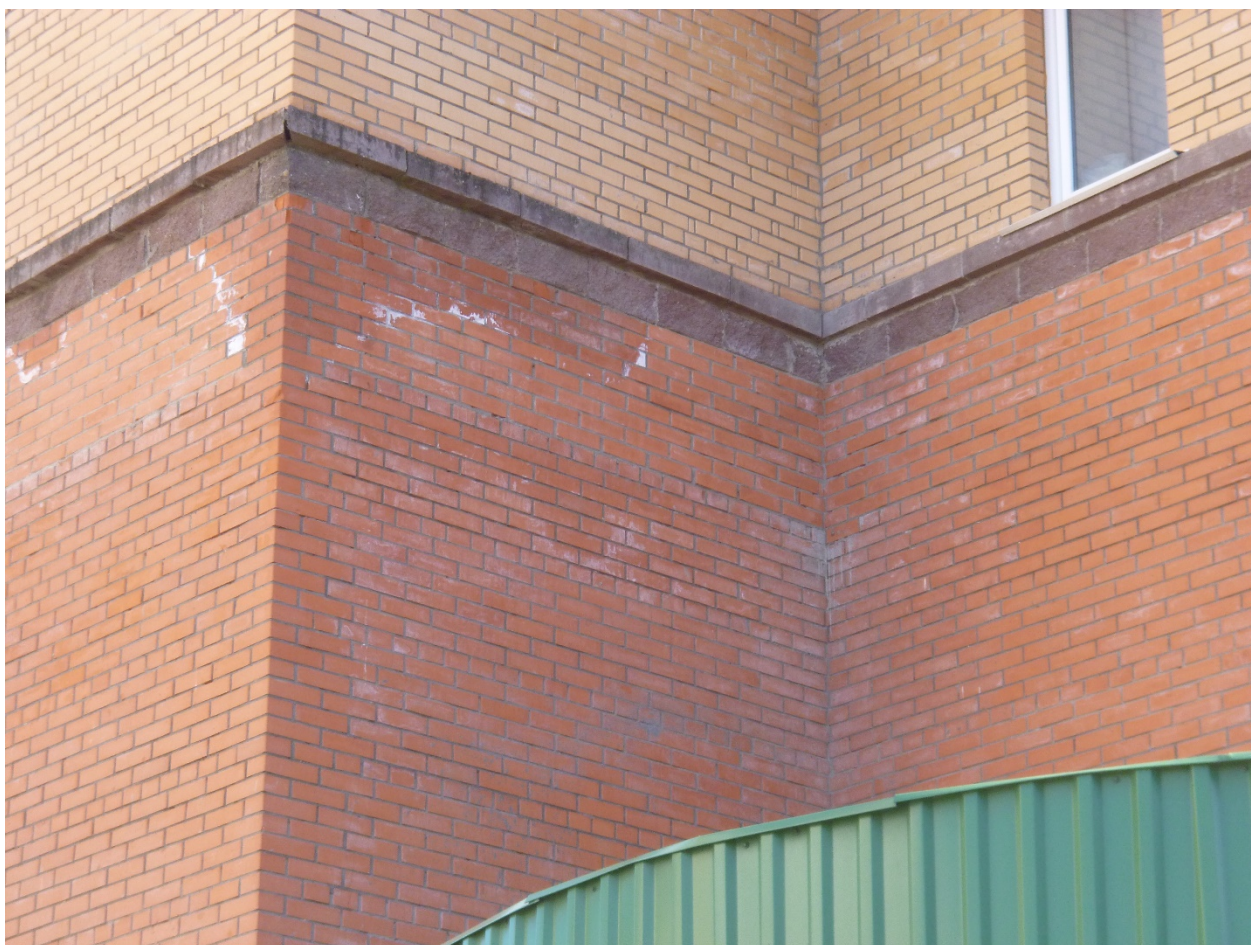
Фотофрагмент № 6 «Высолы на теле кладки»
