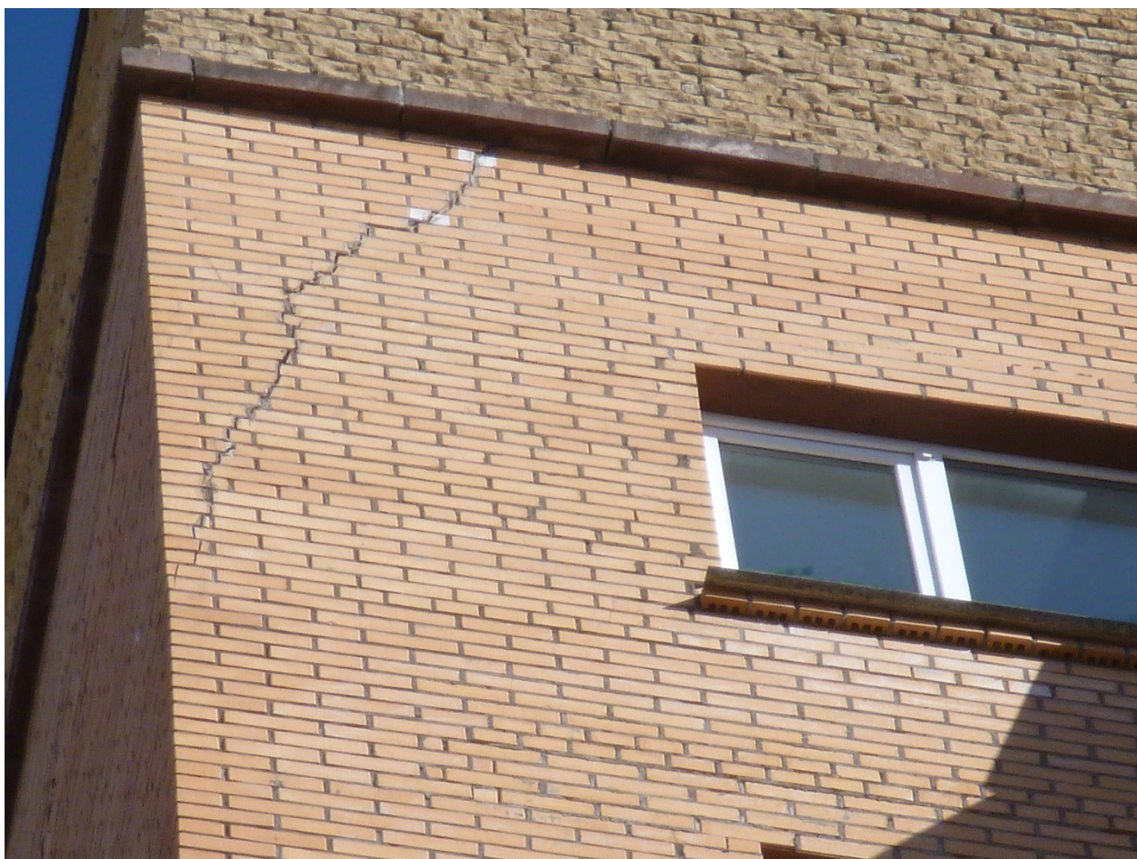
Фотофрагмент № 14 «Трещина в теле кирпичной кладки в углу здания»
