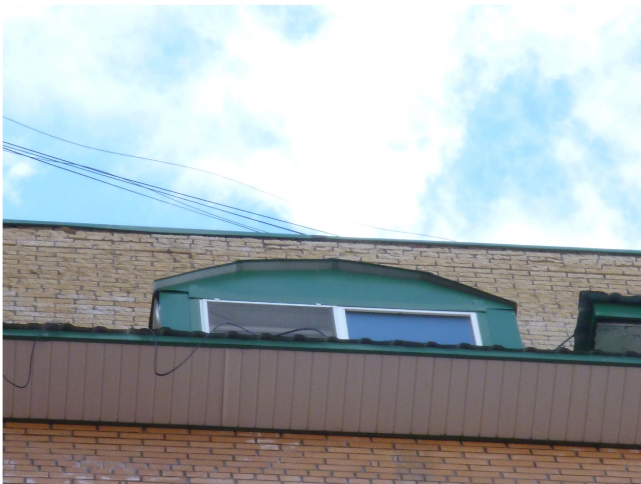
Фотофрагмент № 8 «Низкое качество кирпичной кладки, разрушение кирпича»
