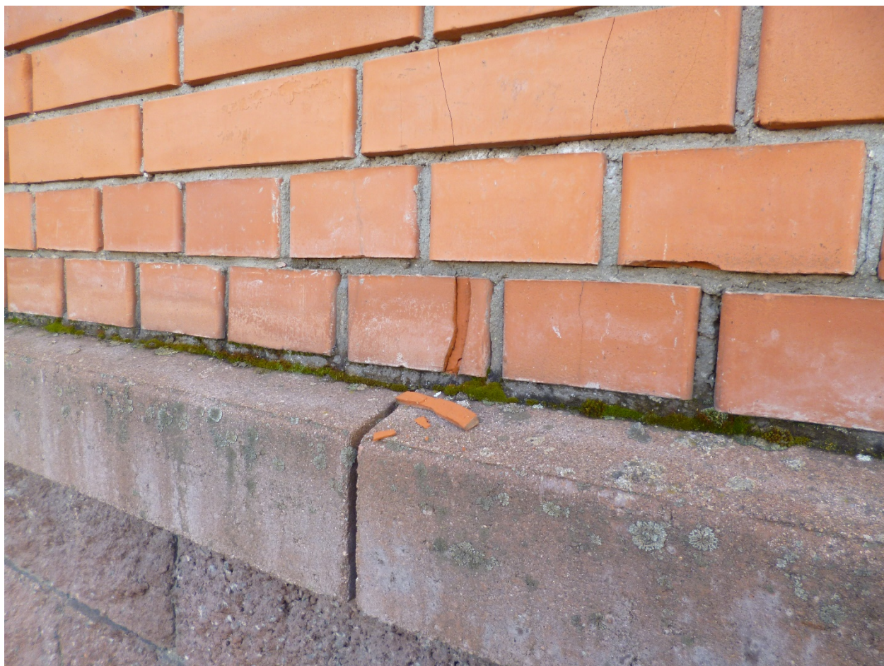
Фотофрагмент № 11 «Разрушения кирпича в зоне образования трещин»
