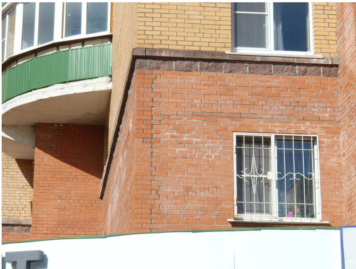
Фотофрагмент № 17 «Трещины в теле кирпичной кладки на углу здания, высолы»
